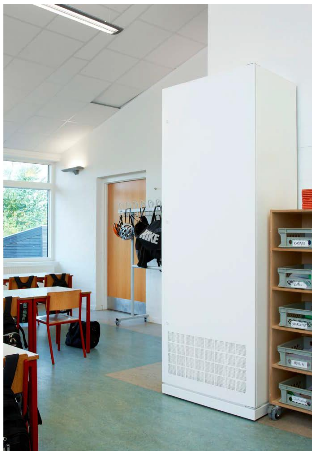
AM 900 instalovány v základní škole
