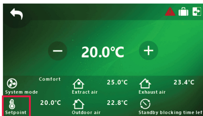
Obr. 5.6.1.4 Požadovaná hodnota teploty SA-Control a SALDA AIR view na obrazovce
